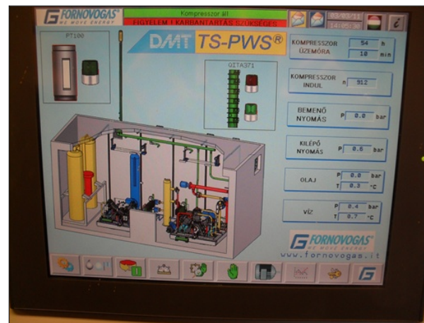
Webscada kontrol grænseflade
