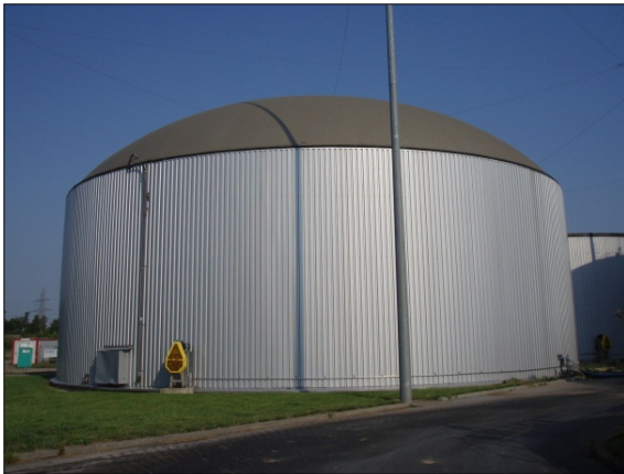
Sekundær rådnetank og gaslager
