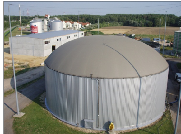
Sekundær rådnetank og gaslager
