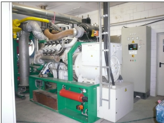
Et af de 2 varmekraftværker, som blev installeret som del af den oprindelige udvikling, og som nu kun bruges som back up
