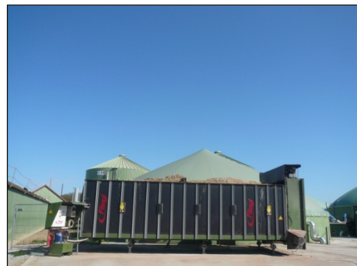
Automatiseret faststofs anlæg
